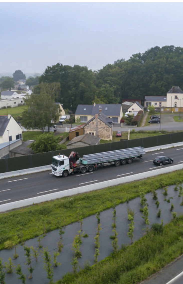
Mur anti-bruit sur la déviation de Tréflieux - RD 771. Source : Paul Pascal / Département de Loire-Atlantique
