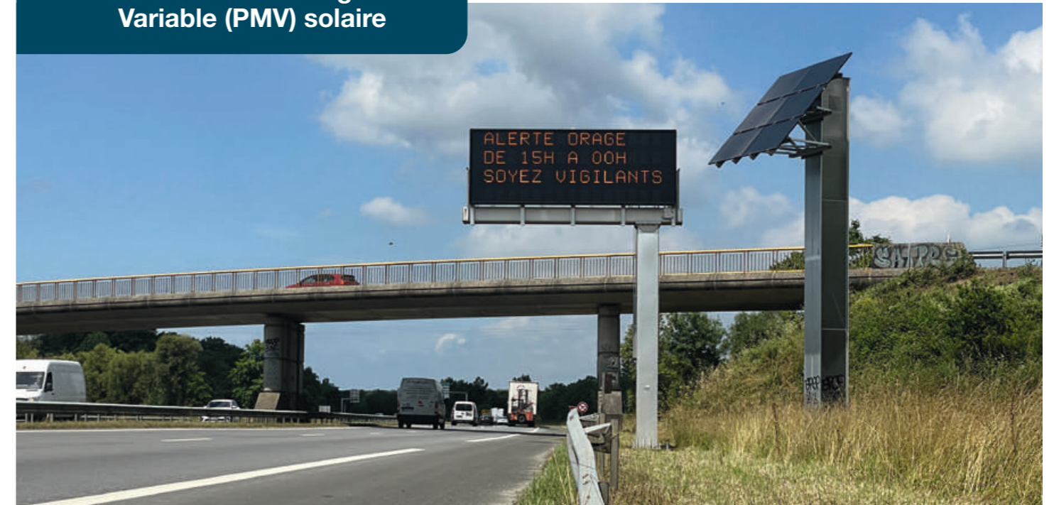
Panneau à Message Variable alimenté par énergie solaire sur la RD 723 à Bouguenais. Source : Julien Lahaie / Département de Loire-Atlantique
