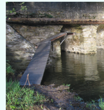
Passage à faune en banquette sur ouvrage existant. Source : Nicolas Boudot / Département de Loire-Atlantique
