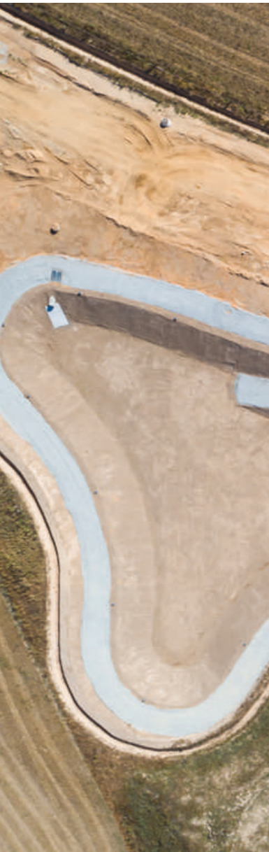
Suivi de chantier - travaux de la déviation nord de Nort-sur-Erdre vus du ciel. Source: Paul Pascal / Département de Loire-Atlantique
